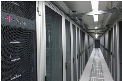
Host: T-Systems (Abb. Rechenzentrum)
